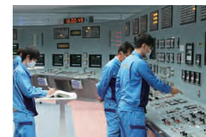
2024年11月15日、 2号機は再稼働した(中央制御室)
