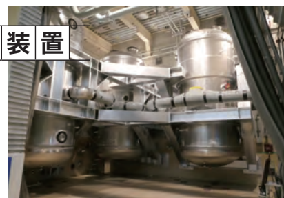
フィルタ付格納容器ベント装置
