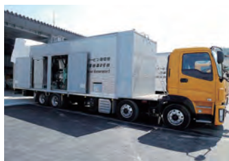
ガスタービン発電機
