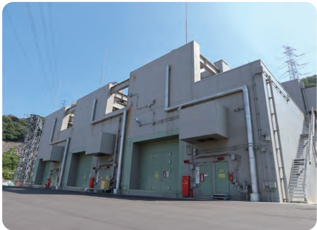
▲ 緊急時に使用する非常用ガスタービン発電機
