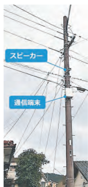
東峰村の防災電柱設備
