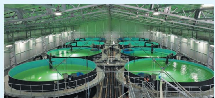
みらいサーモンが最も快適に育つ環境を整えた先進的な海外製プラント設備
