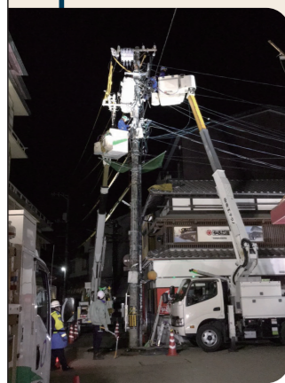
▲文化財保護法をはじめとした各種の法令を遵守しながら引込線を張替えた
