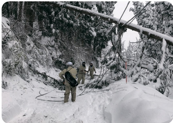
▼ 雪の重みで電線が引っ張られて倒れた電柱の復旧作業
