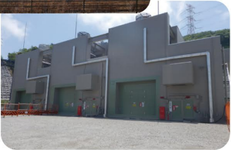
▲ ガスタービン発電機
