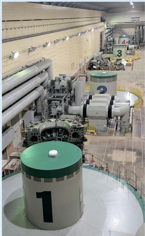
小丸川発電所の内部
