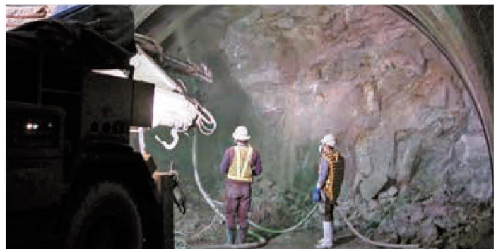
エコパウダーを使用したコンクリートが吹き付けられているトンネル工事現場
