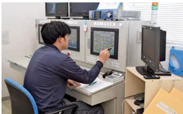
生産設備の状態を常時監視する操作室
