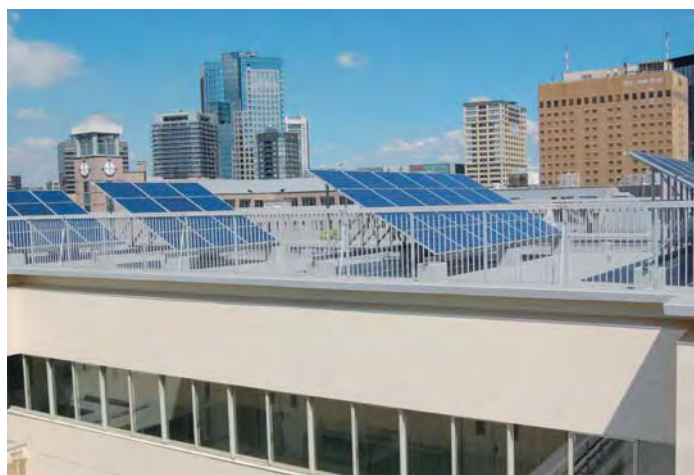
学校の屋上に設置された太陽光パネル
